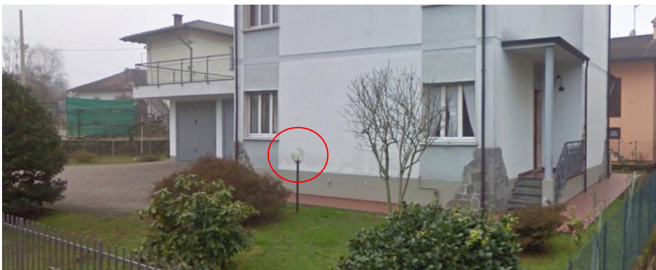
Figura 43. Esempio di illuminazione privata non conforme in via Varallo Pombia. Fonte: Google Maps.
